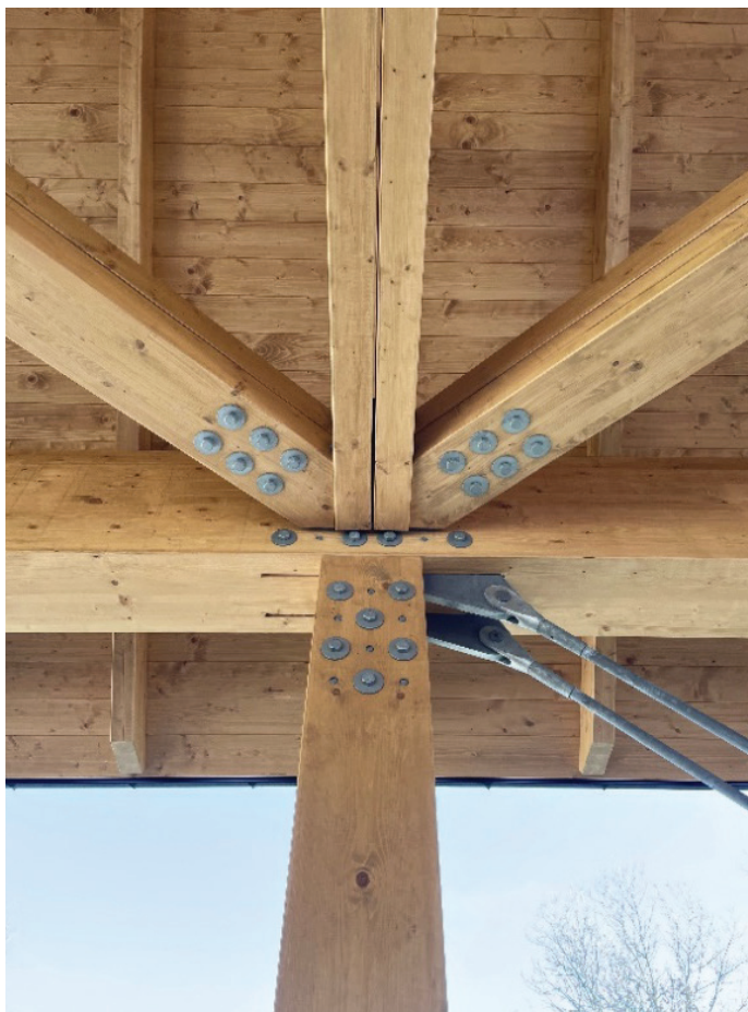
Slika 11. Detajl spoja, december 2024.
