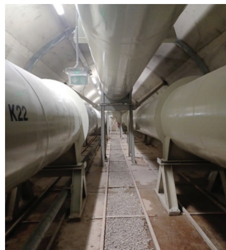
Slika 27. Cevovodi v predoru.
