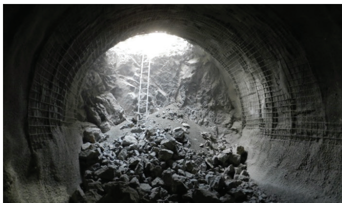
Slika 24. Preboj v gradbeno jamo odzemnih objektov.
