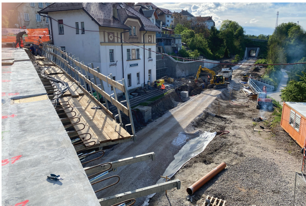
Slika 3 in 4 • Izgradnja novega nadvoza čez železniško progo v Radovljici. Foto: arhiv Direkcije RS za infrastrukturo.
