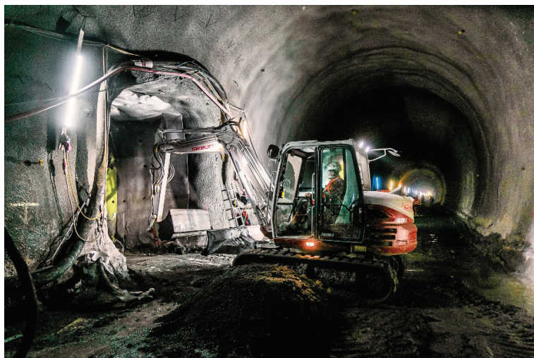
Slika 4 • Nekdanje umikalne niše bodo razširjene v tehnične prostore, v katerih bo po končani sanaciji mogoče nadzorovati in vzdrževati signalnovarnostne in telekomunikacijske naprave v predoru. Foto: arhiv SŽ
