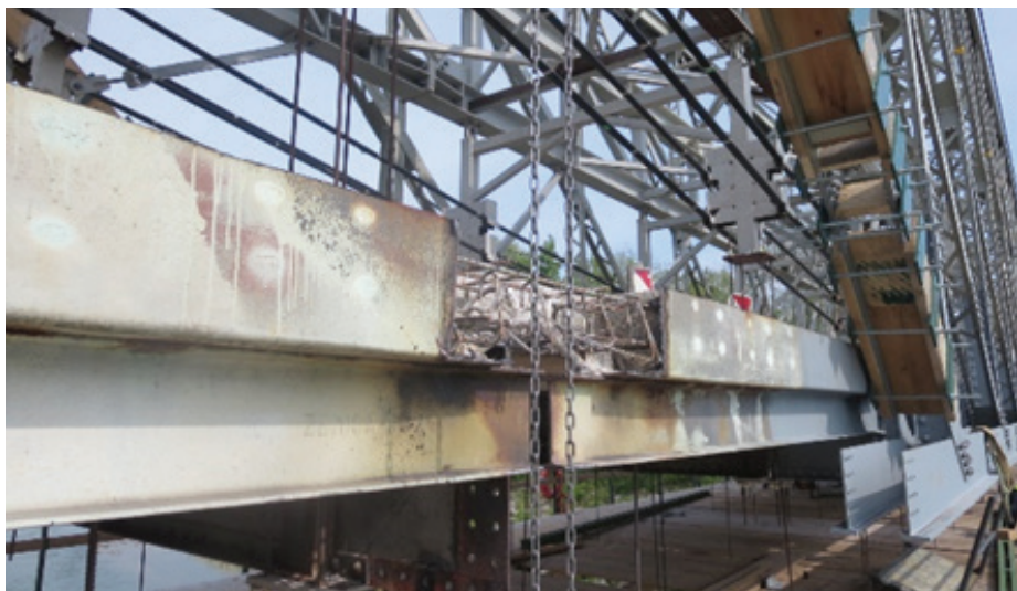
Slika 6 • Odrez dela poškodovanega spodnjega pasu in vertikale.
