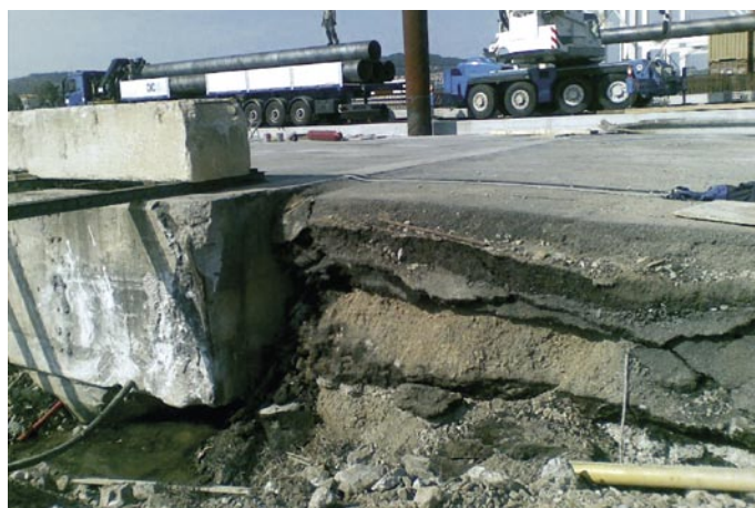
Slika 44 • Posedanje tal ob globoko temeljenih objektih zahteva redno vzdrževanje transportnih poti
