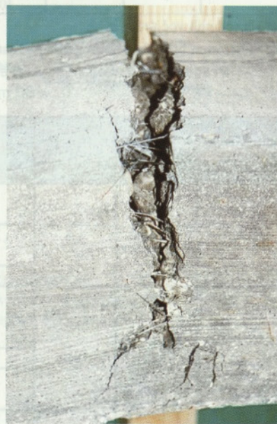
Slika 5: Detajl - delovanje vlaken v upogibni razpoki betona, mikroarmiranega z jeklenimi vlakni
