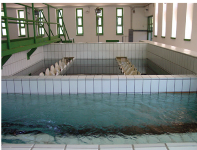
Slika 20 • Na lamelnem usedalniku peska očiščeni obrežni filtrat.
