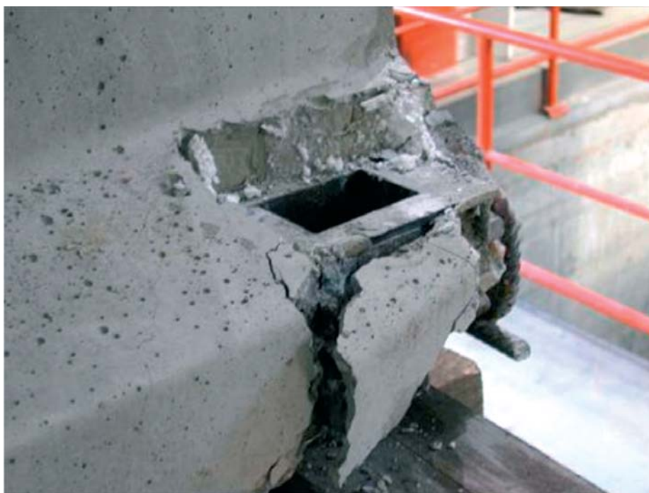
Slika 8 • Poškodba nosilca na stiku s stebrom
