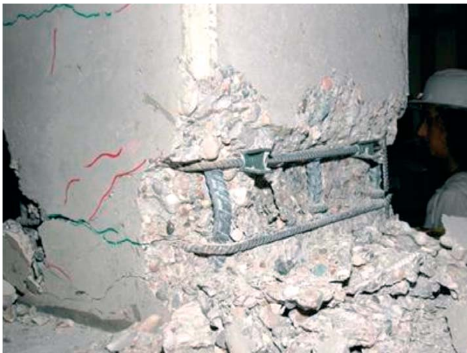
Slika 11 • Značilna upogibna porušitev stebra
