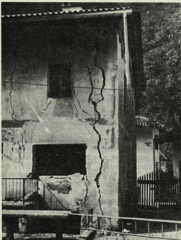
Slika 2. Trganje zidu, pravokotnega na smer potresa
