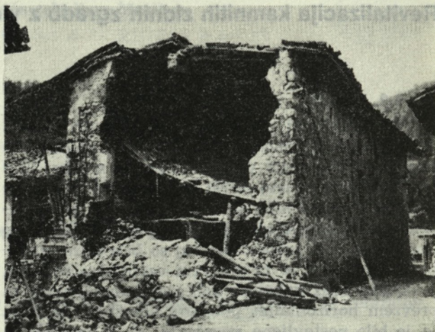
Slika 3. Rušenje zidu, pravokotnega na smer potresa
