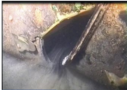
Slika 4 • Nasilna odprtina na zahodnem kraku natege
