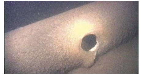
Slika 8 • Nasilna odprtina na zahodnem kraku natege
