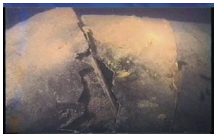
Slika 6 • Nasilna odprtina na zahodnem kraku natege
