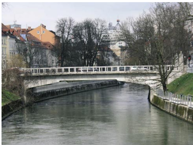
Slika 16 • Šentjakovski most v Ljubljani, zgrajen leta 1915. Je prvi most v Sloveniji z vgrajenim Gerberjevim nosilcem. (foto: G. Humar)
