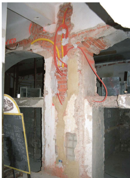
Slika 19 • Primer nevarne oslabitve konstrukcije.
