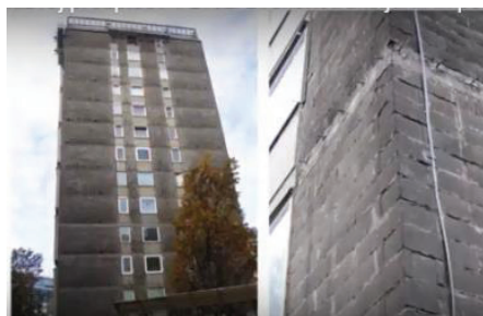
Slika 5 • Potresno neoporna stanovanjska stolpnica v Ljubljani.
