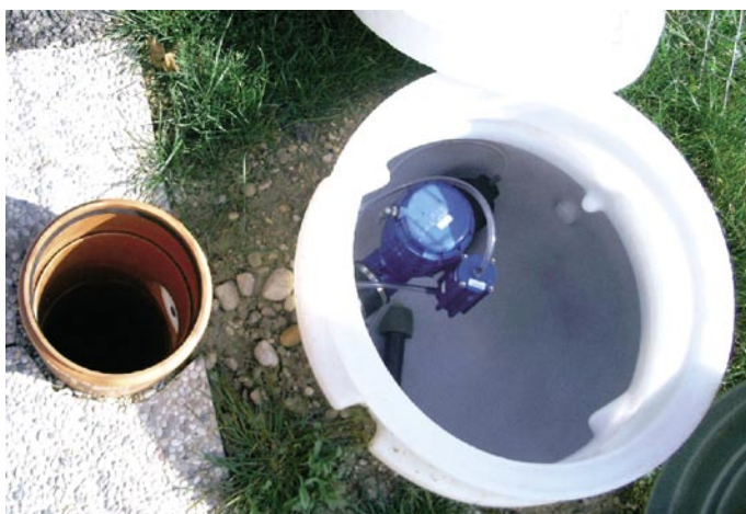
Slika 8 • Pogled na pokrov standardnega jaška ROEVAC
