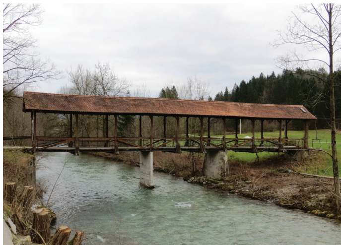
Slika 2. Obstoječa brv pred poplavami avgusta 2023.
