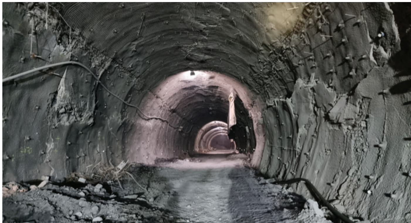
Slika 8. Poškodovana notranja obloga predora na območju permokarbonskih kamnin.
